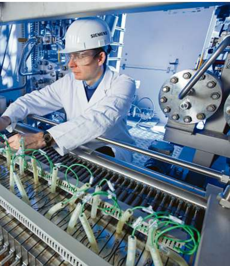
von Siemens zur Elektrolyse ist die Basis für das Pilotprojekt SIEMENS
