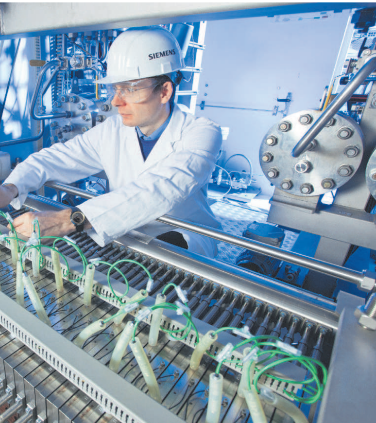
von Siemens zur Elektrolyse ist die Basis für das Pilotprojekt SIEMENS
