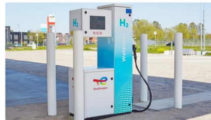
Het waterstof tankstation op de luchthaven van Eelde © TotalEnergies
